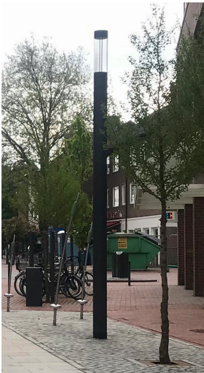
Lichtstele (LED-/Wi-Fi-Lichtbauelemente, Fa. Bega)
