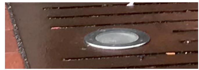
Bodenstrahler im Baumrost
