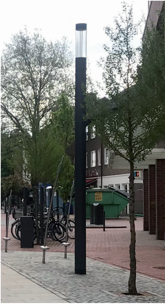
Lichtstee (LED-/Wi-Fi-Lichtbauelemente, Fa. Bega)
