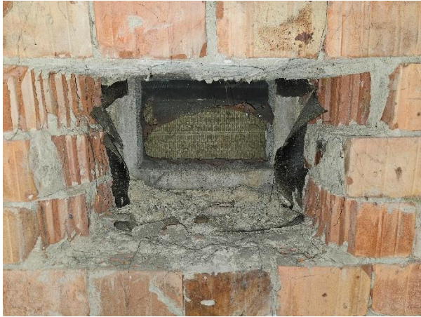
Abb. 3: Loch im Mauerwerk an Südseite
