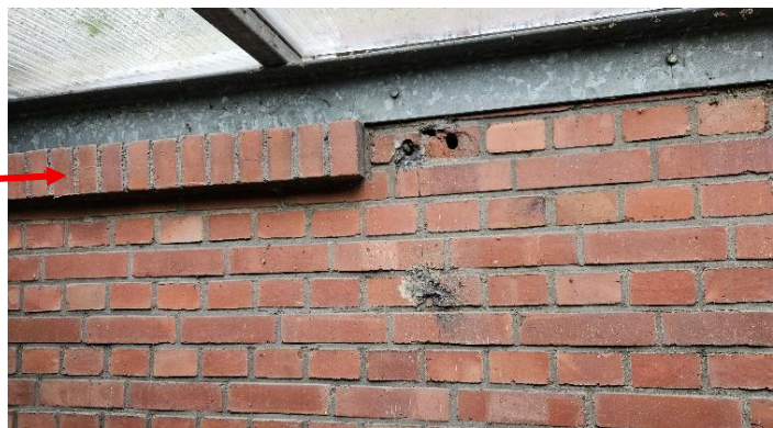
Abb. 6: Einschluß in Mauerwerkshohlschicht
