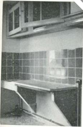
Bild 7 Küche, festeingebaute Einrichtung: Terrazzo-Spülstein und Arbeitsplatte, Wasser- und Gaszapfstellen, Küchenschrank
